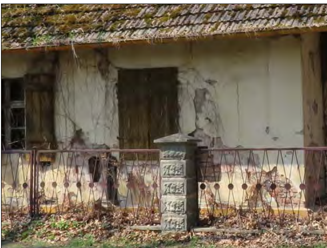
ehemaliges Backhaus Südostseite: Mauerwerksschäden wegen mangelhafter Gebäudegründung, Sperrung und Dachentwässerung
