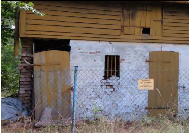
ehemaliges Backhaus Nordwestseite: Mauerwerksschäden wegen mangelhafter Gebäudegründung, Sperrung und Dachentwässerung
