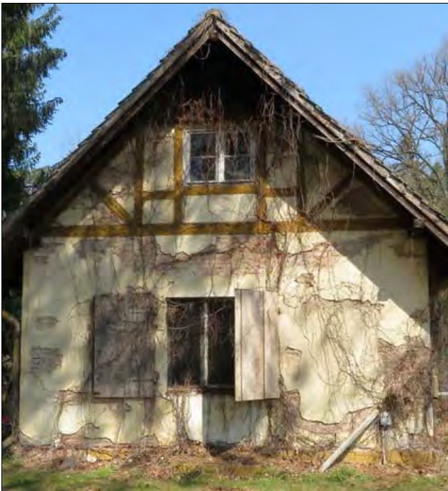
ehemaliges Backhaus Südwestseite: Mauerwerksschäden wegen mangelhafter Gebäudegründung und Sperrung
