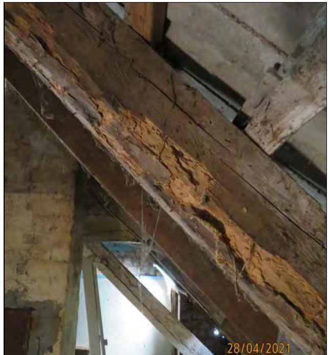
Das Dachgebälk ist wegen Schädlingsbefall und eindringender Feuchtigkeit stark zersetzt
