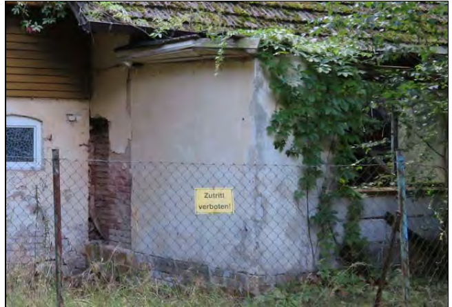
ehemaliges Backhaus Nordwestseite: Mauerwerksschäden wegen mangelhafter Gebäudegründung, Sperrung und Dachentwässerung
