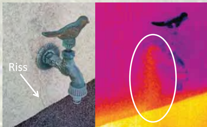
Beschädigung der thermischen Hülle
