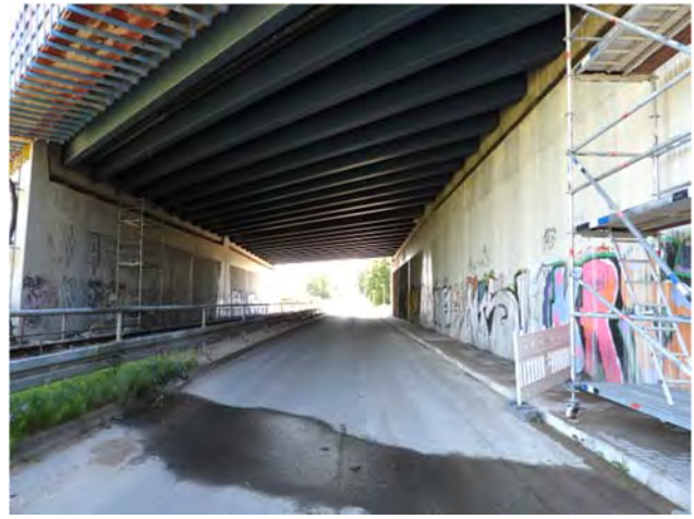
Südöstlich des Plangebietes unterqueren die Bahnlinie der Kremmener Bahn und der Bahnweg gemeinsam die Autobahn A10
