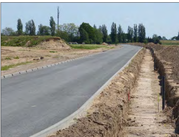
Ausbau Veltener Weg im benachbarten Gewerbepark Vehlefanzen (Foto 05/2019), Blick in Richtung Gewerbegebiet Bärenklau
