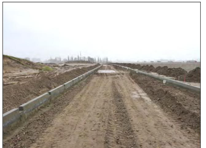
Blick von Nordwest in den im Bau befindlichen Veltener Weg (südöstlicher Teil) März 2019
