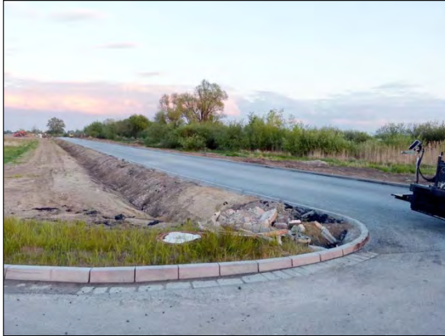
Blick von Nord in den im Bau befindlichen Veltener Weg mit Niederschlagsentwässerungsmulde - Mai 2019
