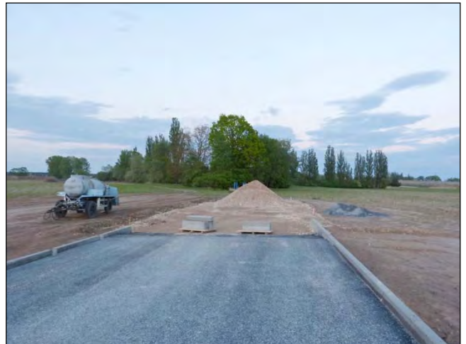
Blick von West zum Endstand des bisherigen Ausbaus der Straßentrasse des Veltener Weges am Rand der Gemar- kung Vehlefan – Mai 2019
